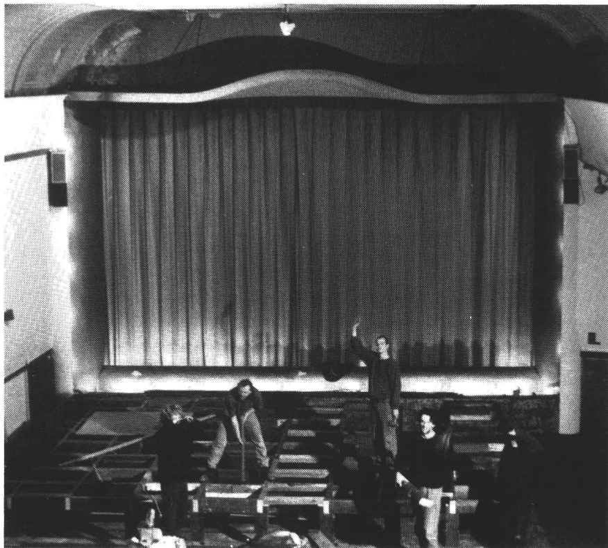
De bouw van het podium in Cultureel Centrum de X, 1993 (foto M. van Dam).
