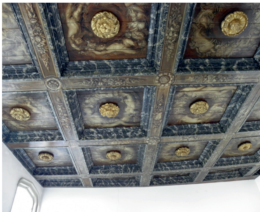
Het plafond dat recent onder de stuclaag werd gevonden.
